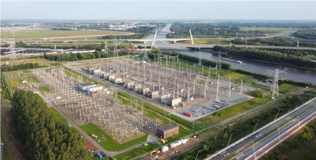
Figuur 2-3 | afbeelding van een 380/150kV-station (Diemen, ca. 18 ha)
